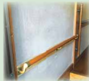
手すり設置の例
