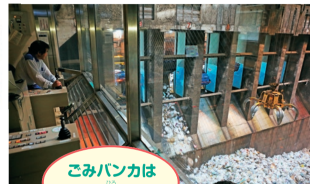
▼生ごみ・紙くずなどのごみが均一に燃えるように、ごみバンカのごみをクレーンでかき混ぜます
