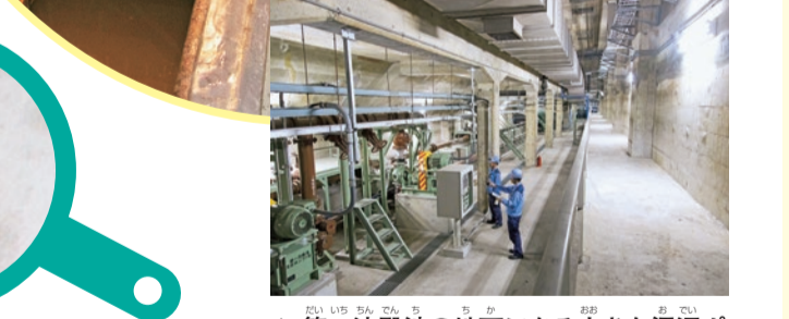
▲第一沈殿池の地下にある大きな汚泥ポンプ。沈殿池の汚泥はこの汚泥ポンプで吸い出し、処理場へ送られます
