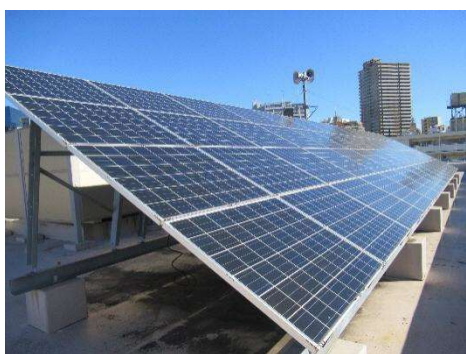
太陽光発電設備（あらかわエコセンター）
