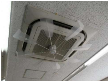
空調機器装置
