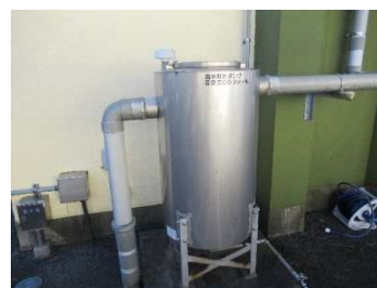
雨水貯水タンク
