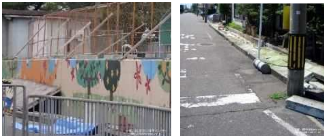
図 1-7 地震によるブロック塀等の倒壊状況
