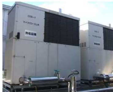
コージェネレーション (高効率機器)の採用
