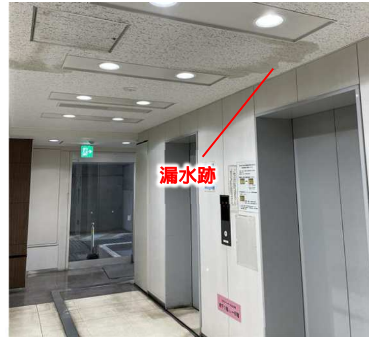
<配管の老朽化による漏水>
