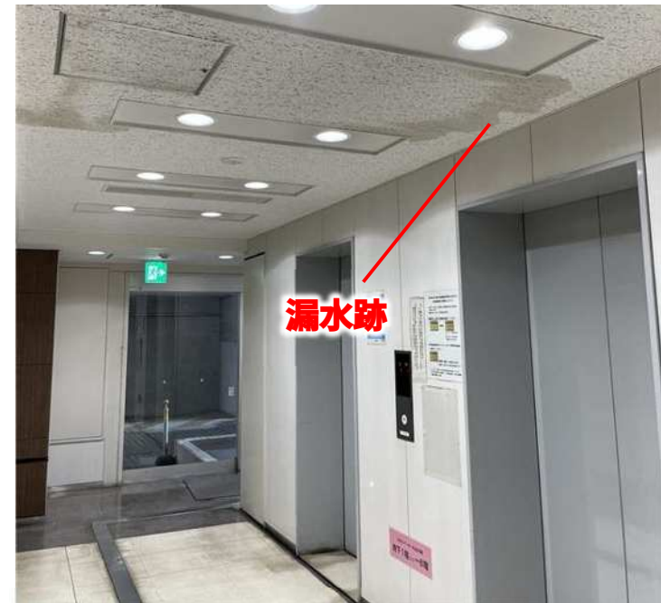
＜配管の老朽化による漏水＞
