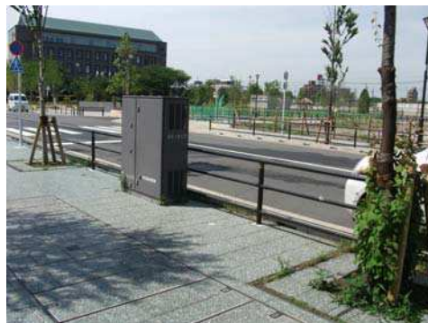
防護柵と同系色の落ち着いた塗装がなされた地上機器（足立区）
