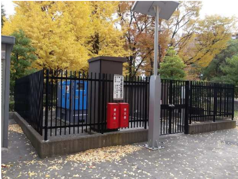
荒川公園内の永久水利施設
