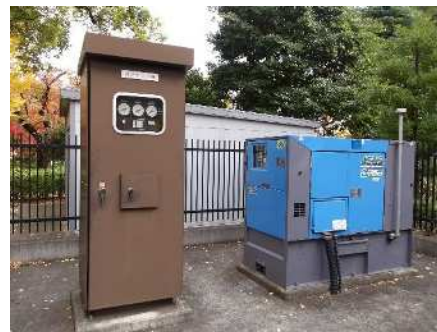
発電機と操作盤
