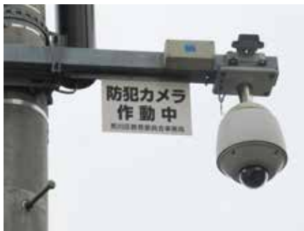
◀ 電柱に設置された防犯カメラ
