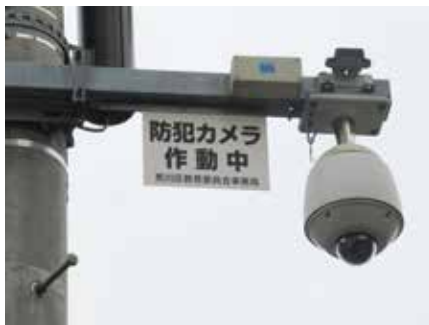
◀電柱に設置された防犯カメラ
