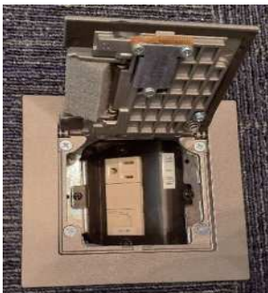
持込器具使用電源 (消費電力 1KW 以内)
