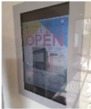
デジタルサイネージ (エントランス表示)
