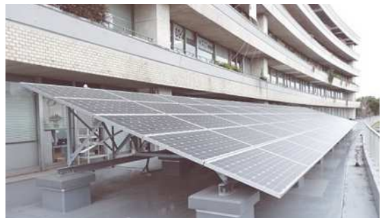
▲荒川区役所の太陽光パネル
