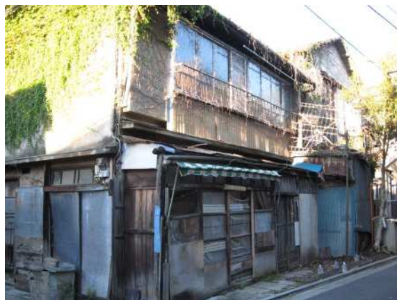
老朽化が進み空き家となっている木造住宅
