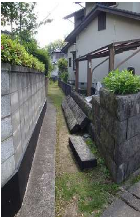
平成 28 年熊本地震における ブロック塀等の被害の実例
