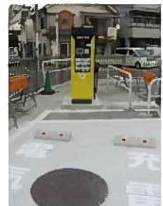
▲荒川区役所本庁舎設置のEV用急速充電設備
